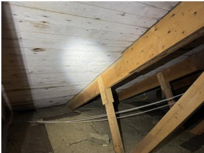
Bild visar mikrobiell påväxt mot underlagstaket.
