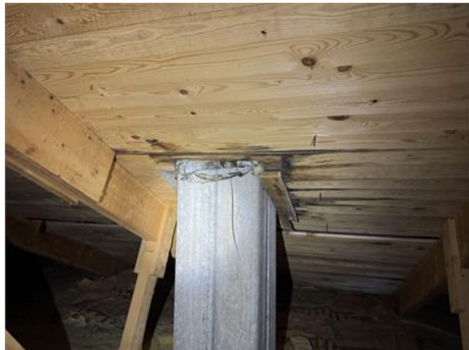
Bild visar fuktrelaterade missfärgningar vid genomföring. Inga förhöjda fuktvärden uppmättes.
